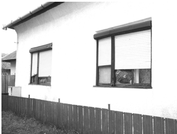
Rómsky dom na hlavnej ulici s rozbitými oknami.
